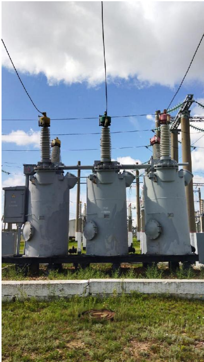
Фото до замены масляных выключателей 110 кВ
