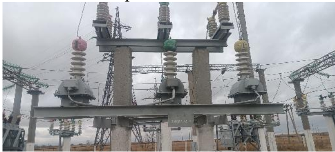
Фото до замены трансформаторов напряжения 35 кВ
