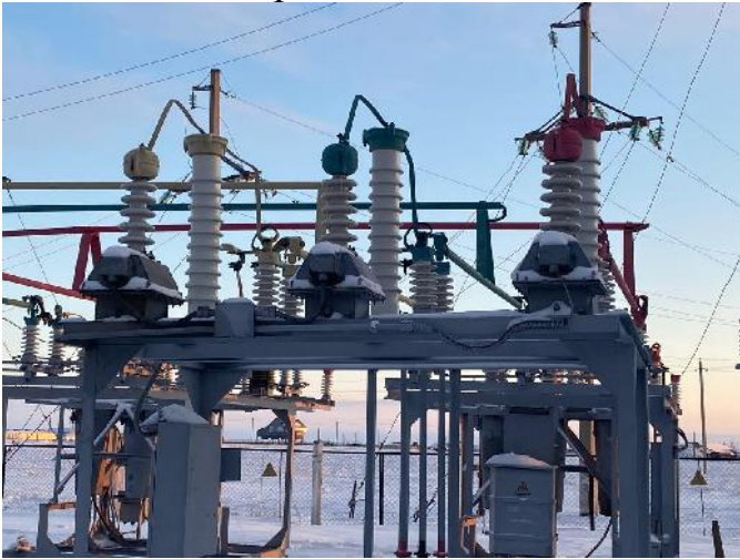
Фото до замены трансформаторов напряжения 35 кВ
