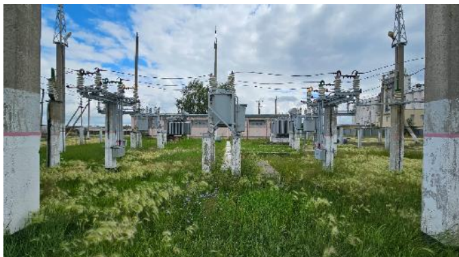
Фото до замены масляных выключателей 35 кВ
