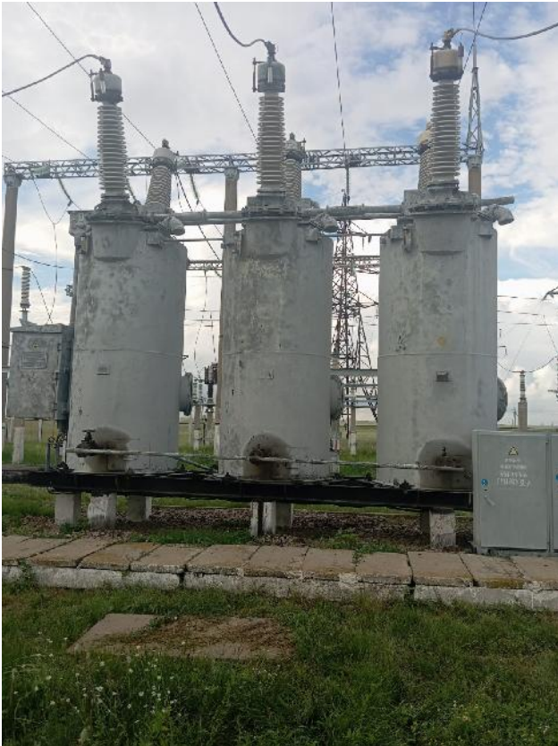
Фото до замены масляных выключателей 110 кВ
