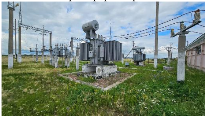
Фото до замены силового трансформатора
