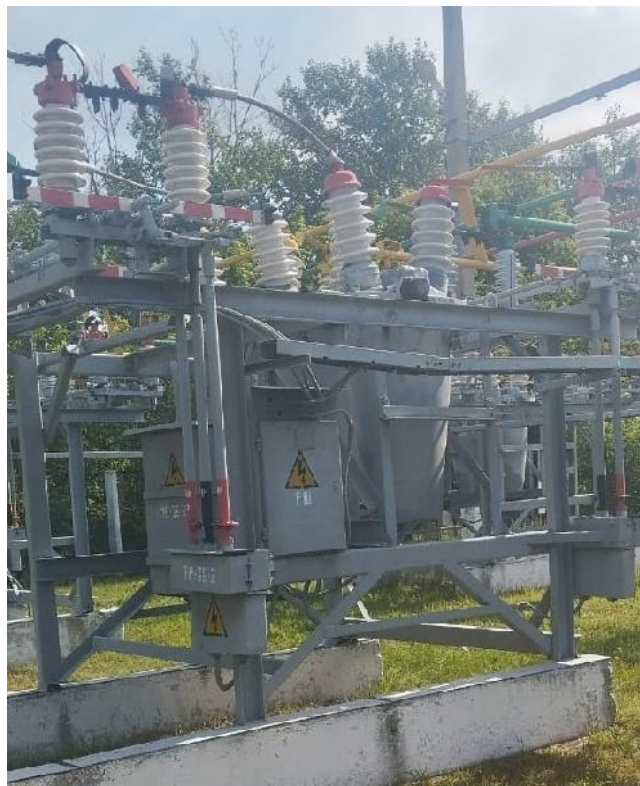
Фото до замены масляных выключателей 35 кВ
