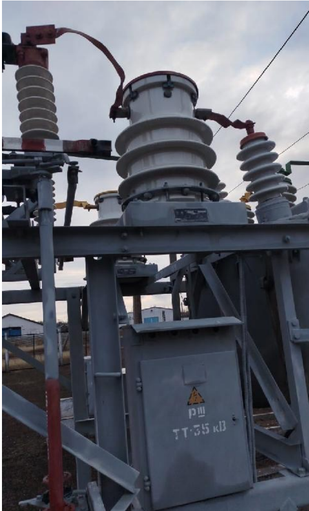
Фото до замены трансформаторов тока 35 кВ
