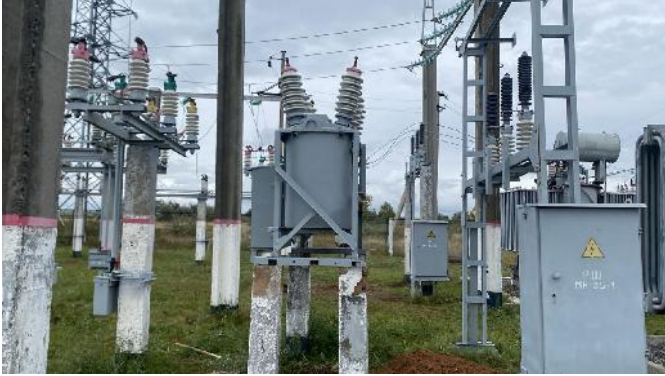
Фото до замены масляных выключателей 35 кВ
