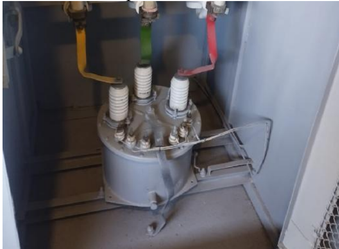
Фото до замены трансформаторов напряжения 10 кВ
