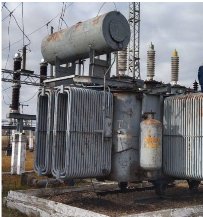
Фото до замены силовых трансформаторов
