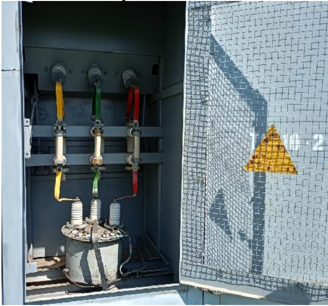
Фото до замены трансформаторов напряжения 10 кВ
