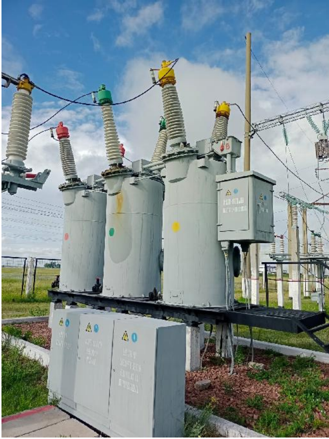
Фото до замены масляного выключателя 110 кВ
