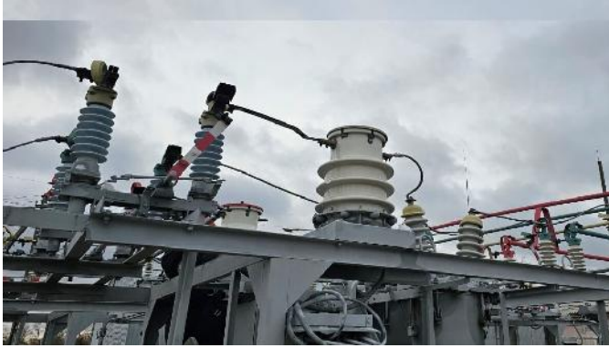
Фото до замены трансформаторов тока 35 кВ
