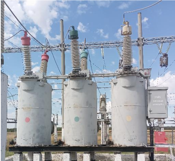
Фото до замены масляных выключателей 110 кВ
