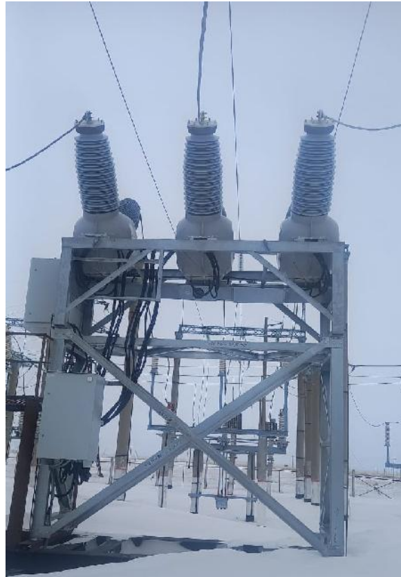
Фото после установки элегазовых выключателей 110 кВ
