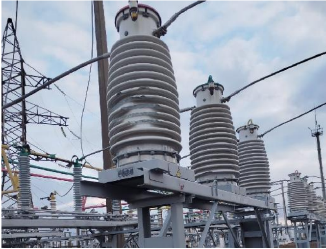
Фото до замены трансформаторов тока 110 кВ
