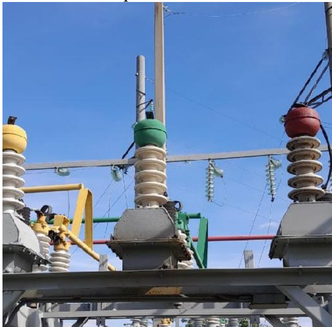
Фото до замены трансформаторов напряжения 35 кВ
