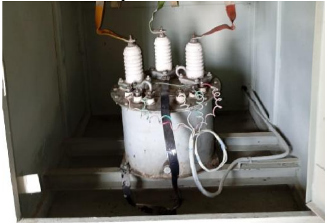
Фото до замены трансформаторов напряжения 10 кВ
