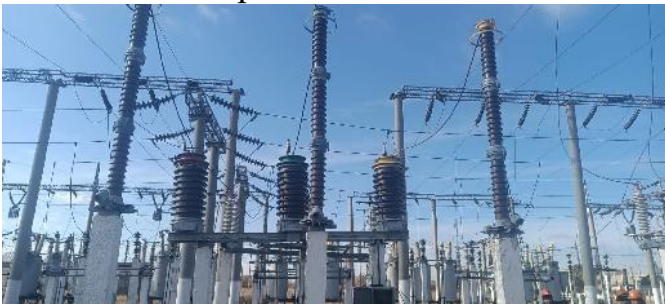
Фото до замены трансформаторов напряжения 110 кВ
