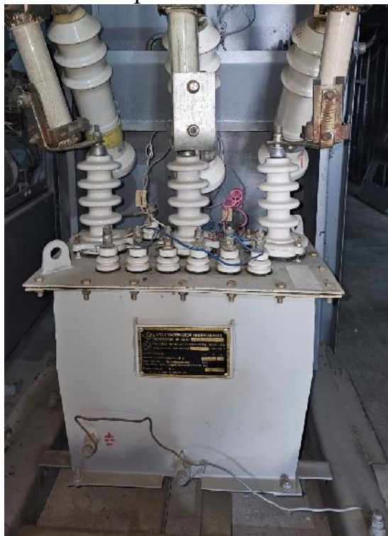
Фото до замены трансформаторов напряжения 10 кВ
