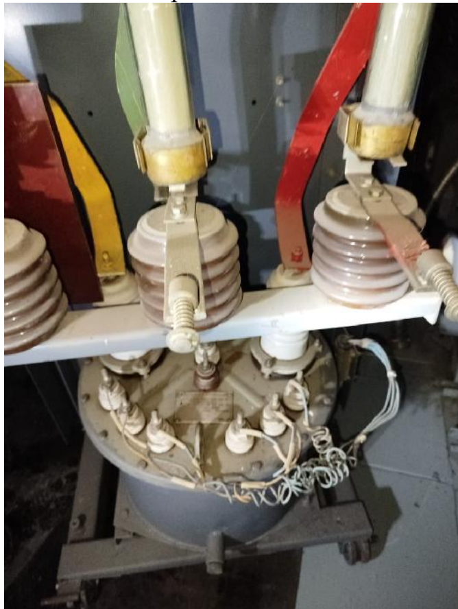
Фото до замены трансформаторов напряжения 10 кВ
